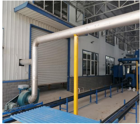
热洁炉废气管道
