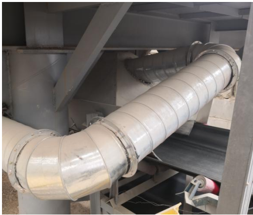
四破后物料输送废气集气罩及管道
