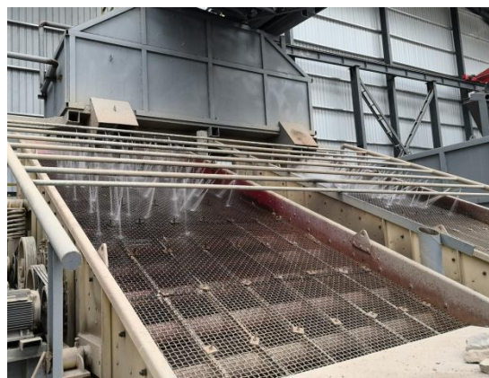
筛分工序水喷淋设施
