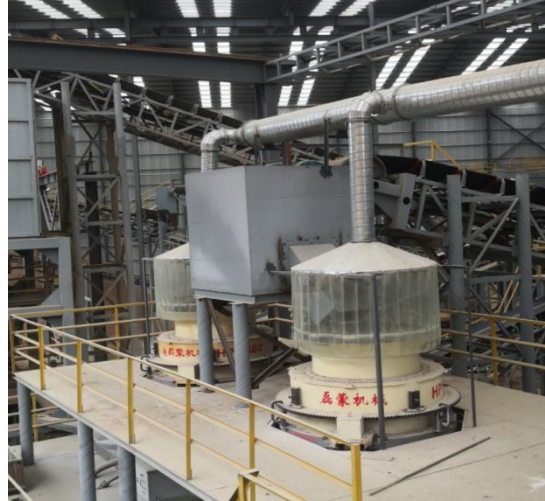
三破、四破废气集气罩及废气管道
