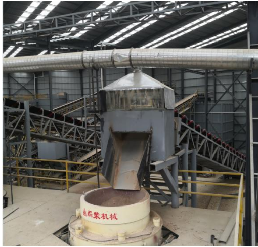
二破废气集气罩及废气管道
