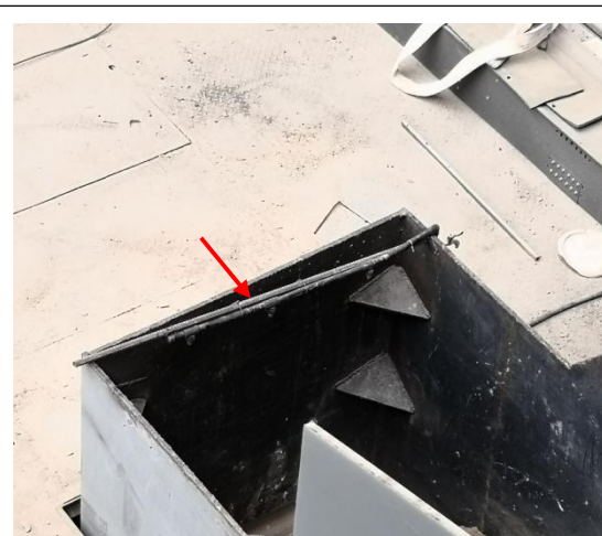
初破水喷淋设施
